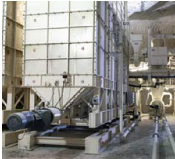
Abbildung 7: Baustoffanlage I auf der 700-m-Sohle (HMGU, 2008).
